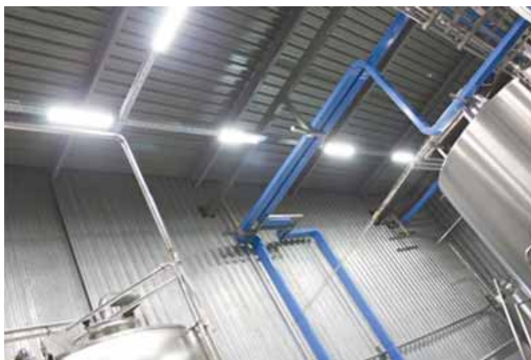
Освещение производственных помещений светодиодными лампами
